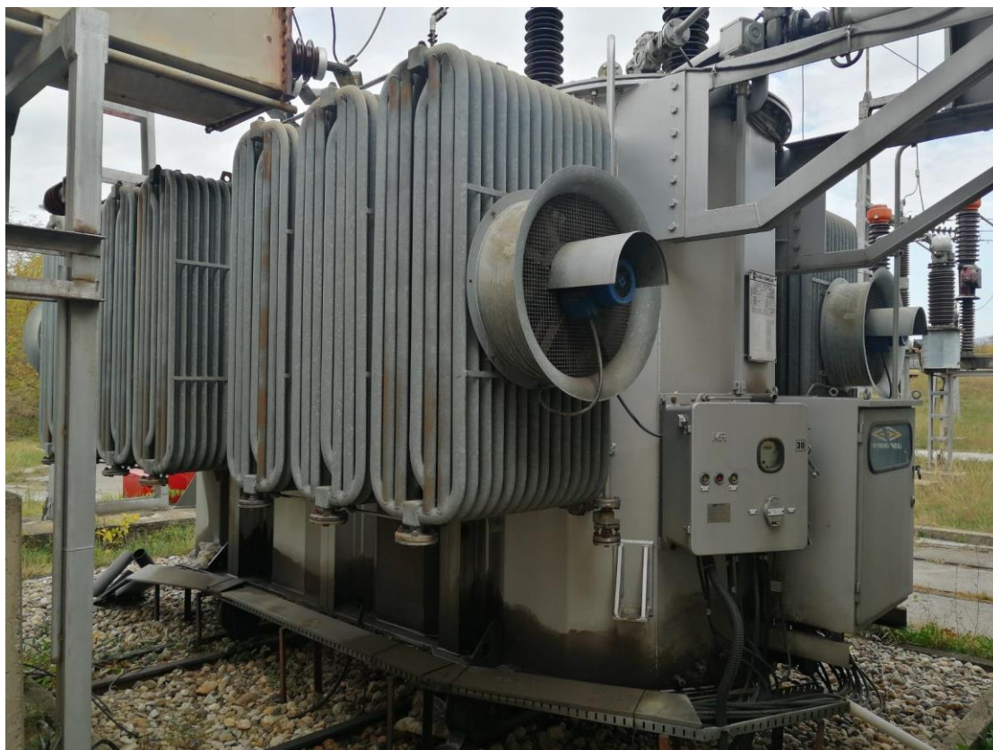
Slika 2: Posmatrani uljni energetski transformator
